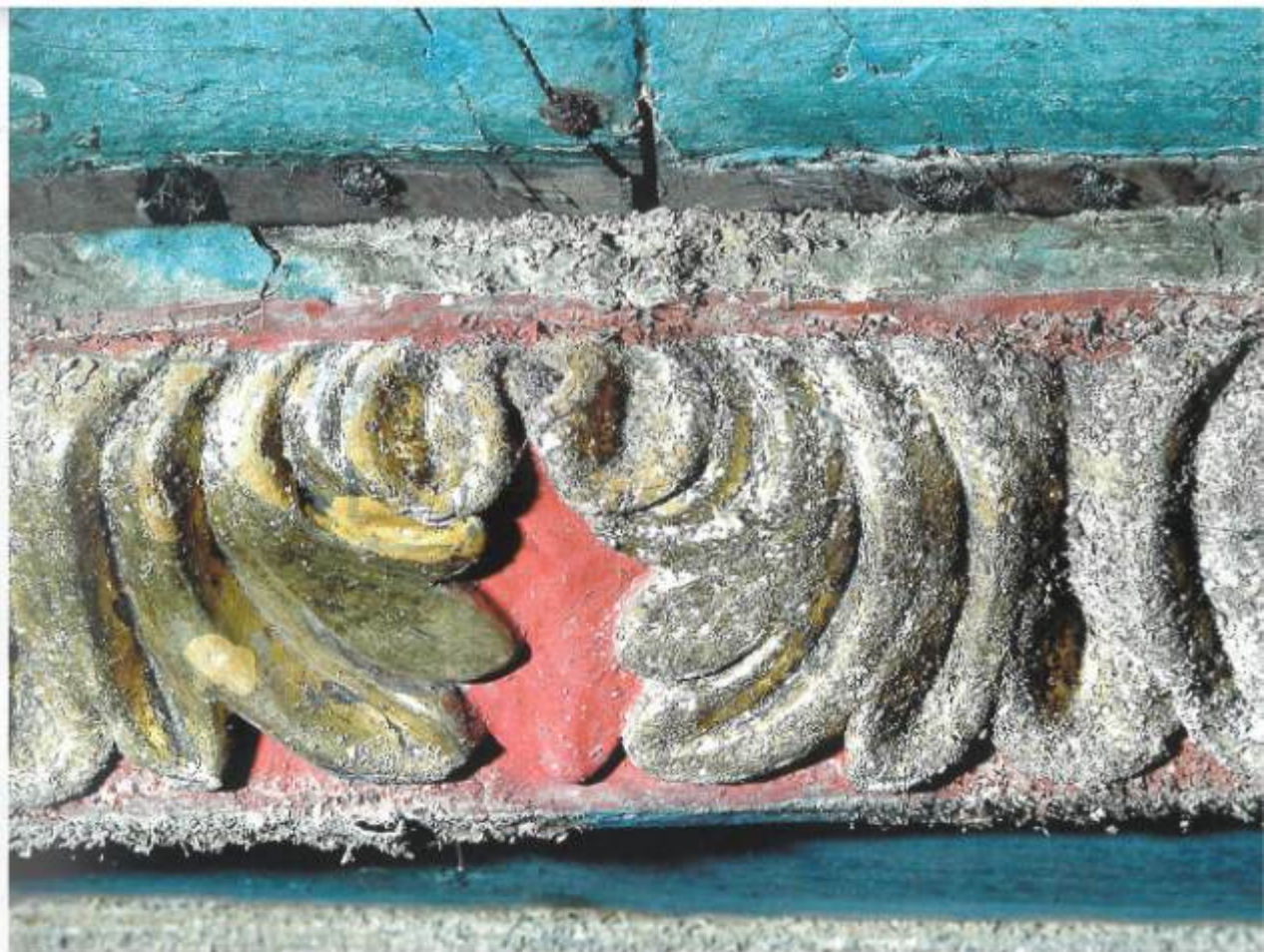
Parmenor da fase de levantamento: douramento e policromia em desagregação, pregos em corrosão ativa.
