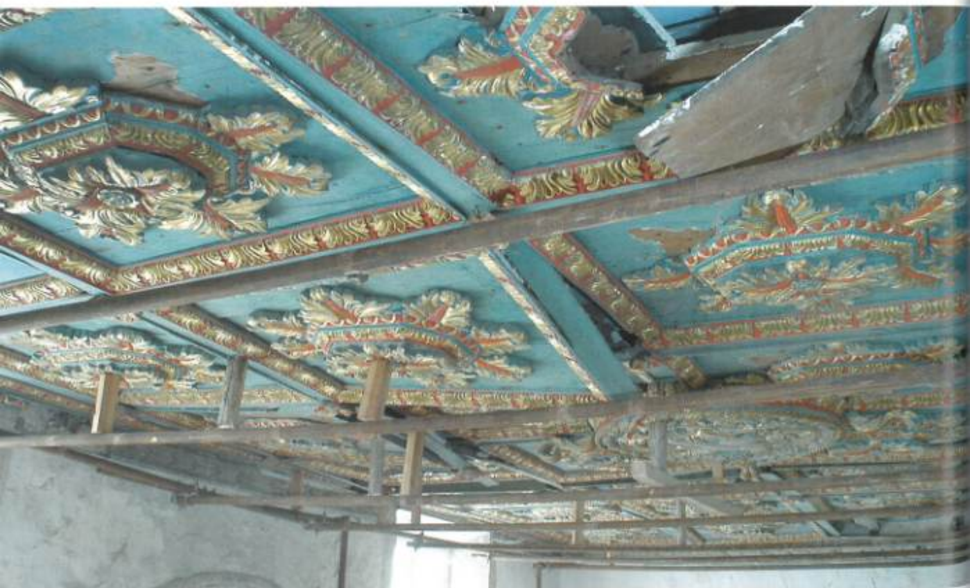
Aspeto geral do teto em 2006, antes da intervenção: com estrutura de escoramento, caixões com componentes em risco de queda, perda de elementos, pregos em corrosão ativa.
